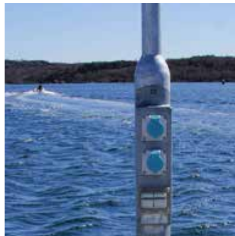
Stolpe med belysning och eluttag längst ut på bryggan gör det möjligt att använda anläggningen i sämre ljusförhållanden, samt att exempelvis ladda elmotorer eller ansluta tex högtalare och andra apparater vid ett evenemang.
