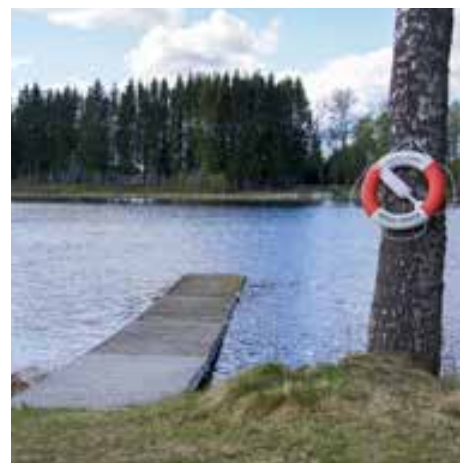
(B) Avesta Roddklubbens brygga i Dalälven. I dåligt skick och tenderar att sjunka under vattenytan om fler än tre personer står på samma ställe. Stort behov av nybyggnad. Ca 18 m lång.
